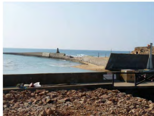
Endommagement de la jetée et de l'écluse de la Gachère (au sud de Brétignolles-sur-mer) dû à l'action des vagues
