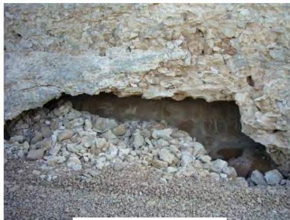
Endommagement de digues
