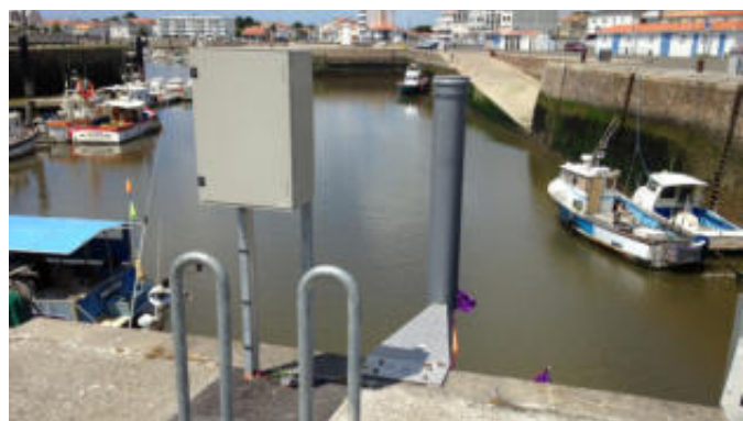
Marégraphe installé dans le port de Saint Gilles Croix de Vie
