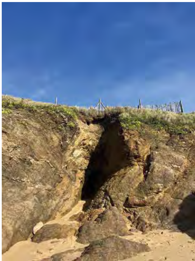
Photo 25 : Cavité dans la corniche, Brétignolles sur Mer
